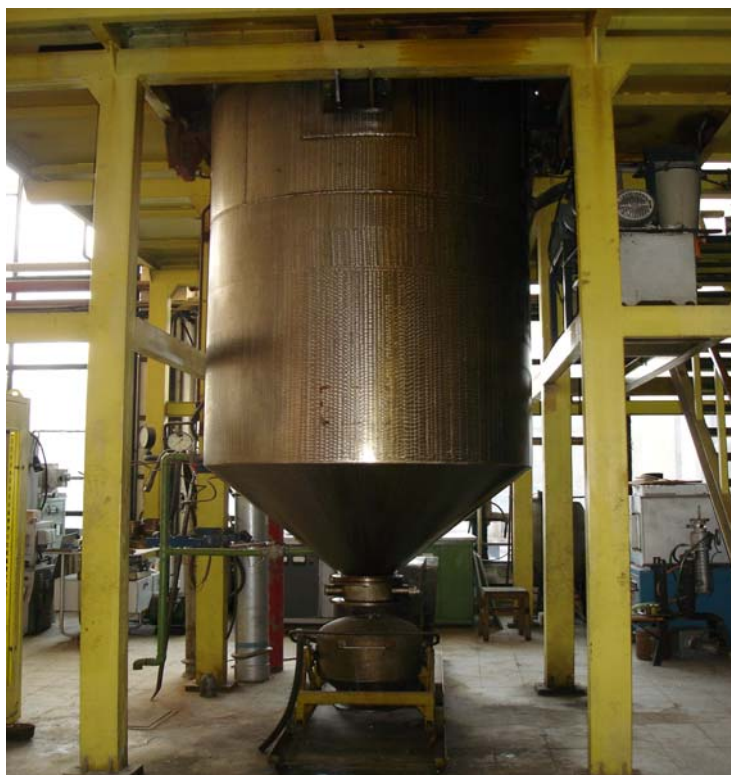
Fig. 3.16 Ansamblul instalației de atomizare
